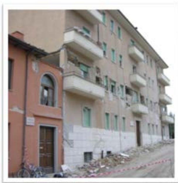
Fig.3.14. Avarii la o clădire cu patru niveluri datorită lovirii de clădirea cu două niveluri alăturată, Cutremurul L'Aquila, Italia, 6 Aprilie 2009, 5,8 Richter
