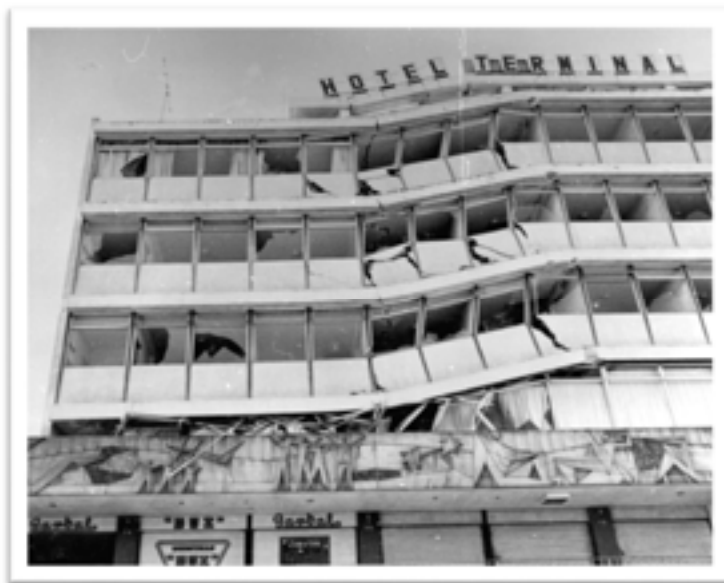
Fig.3.4. Avarii datorate torsiunii cu prăbusirea etajului 2, Hotel Terminal, Guatemala, 4 feb 1976, seism 7,5 Richter, USGS, Figure 55, Professional paper 1002, imagine publică
