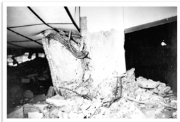
Fig.3.5. Avarii datorate torsiunii generale a clădirii, avariarea stâlpilor și căderea etajului superior către dreapta, Hotel Terminal, Guatemala, 4 feb 1976, seism 7,5 Richter, USGS, Figure 74, Professional paper 1002, imagine publică
